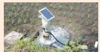
遠隔監視による水管理
