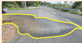
パイプラインの漏水のしみ出し
